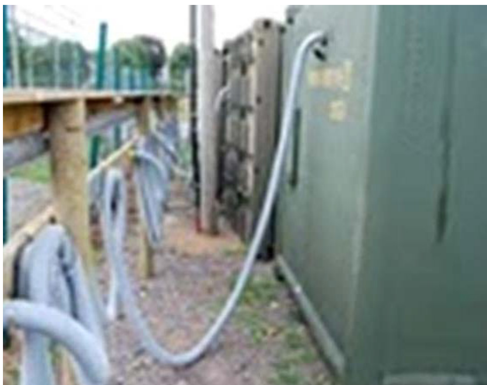
Bild 4. Avfuktningssrampe för objektvis avfuktning
